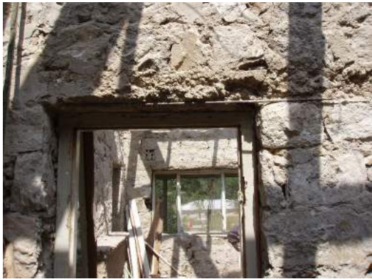
Broken lintel above the door
